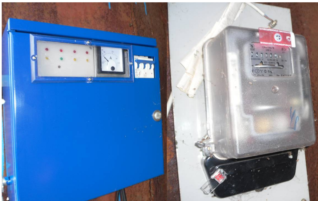
Рис. 1.3. Электрический щит и шкаф прибора учета электроэнергии
